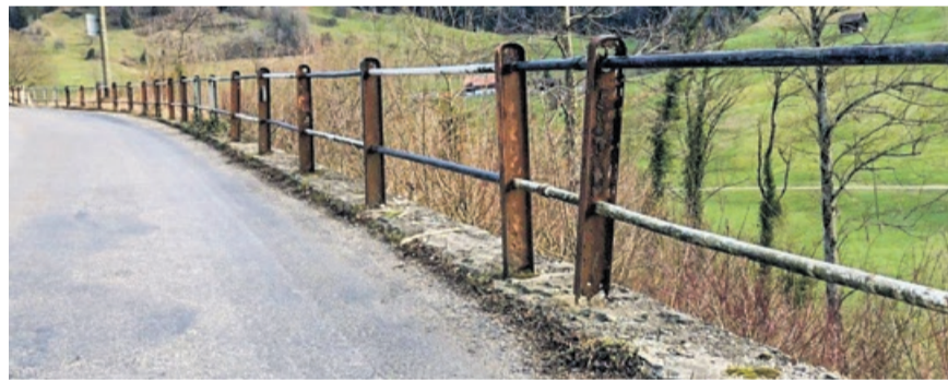
Heutiger Zustand der Absturzsicherungen bei der Rampe Neuhüsli.
